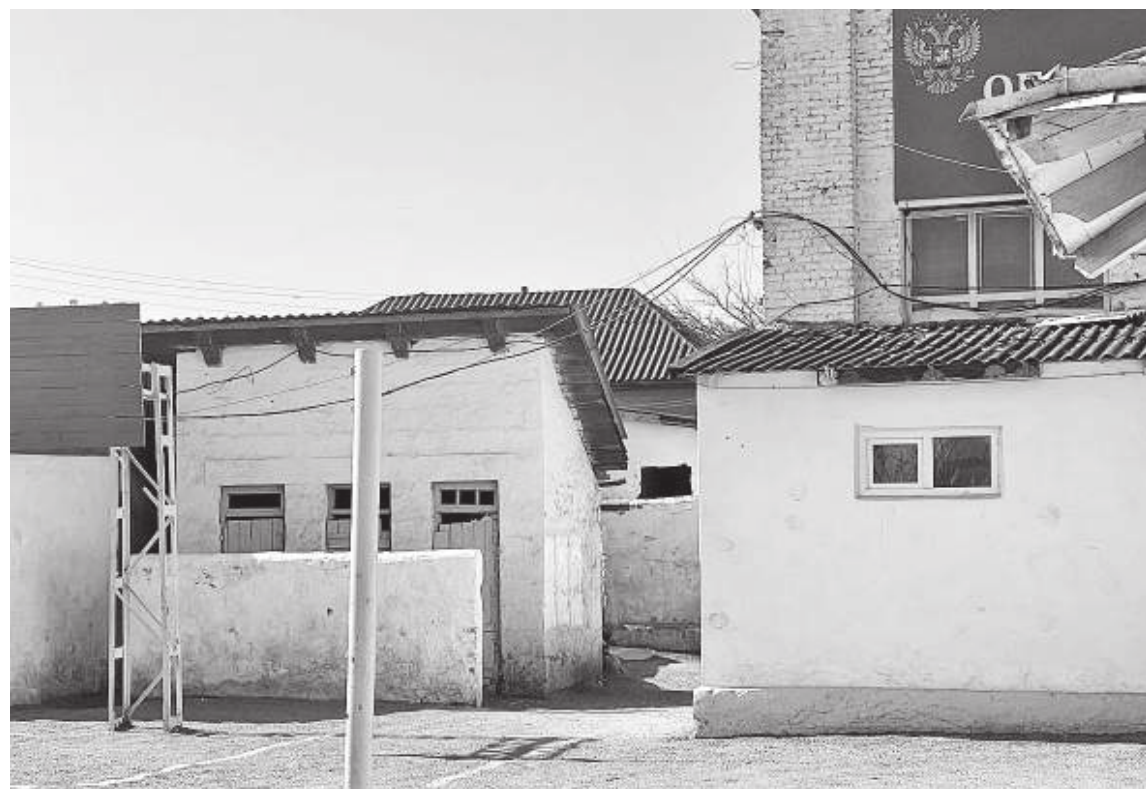
Расположенные на улице школьные санузлы без канализации
